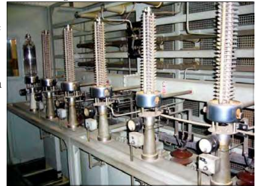
Solid state rectifiers.
